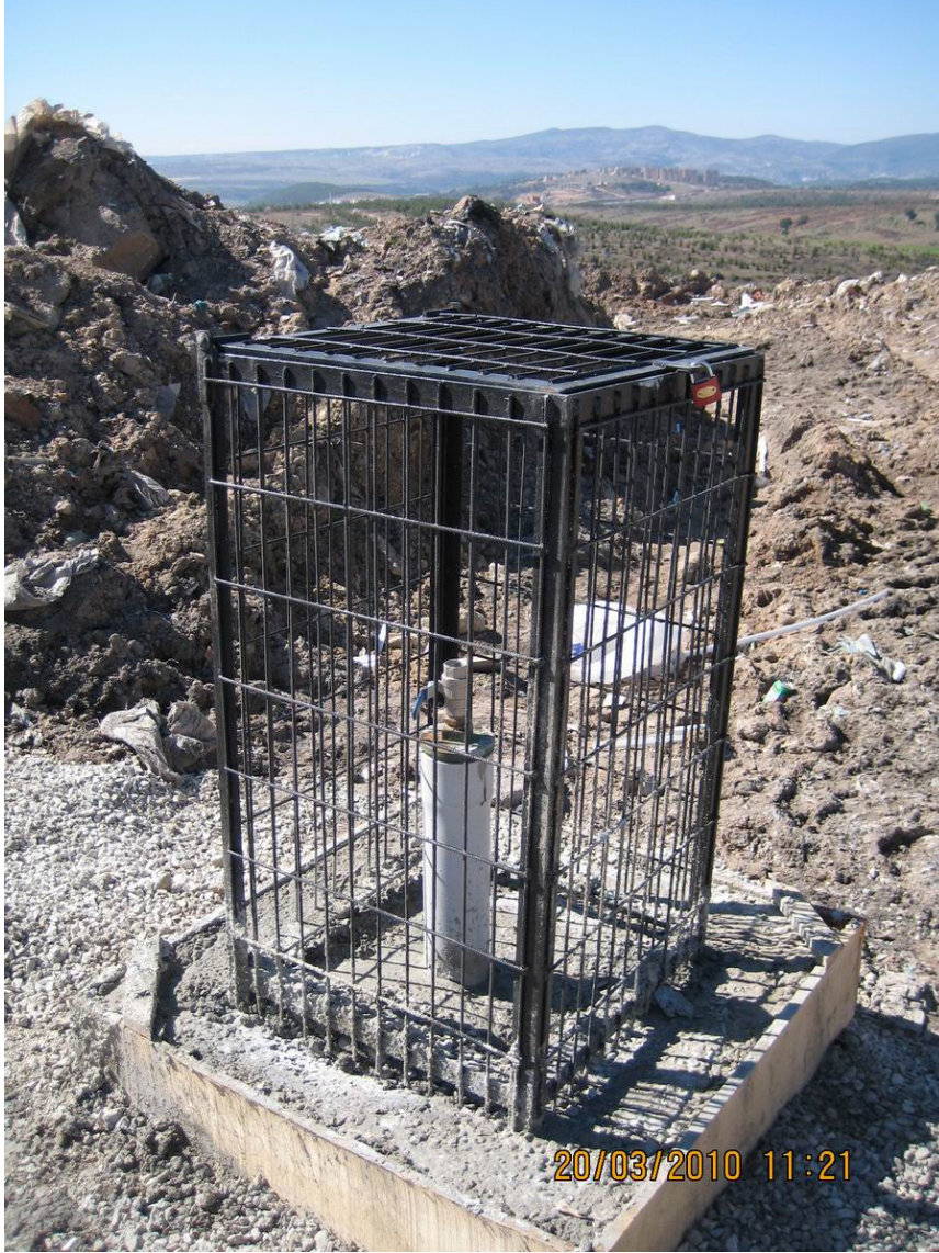
Şekil 67: Çalışmaları bitmiş gaz ölçüm bacası
