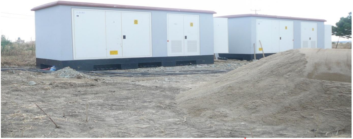
HAVA ALANI SU DEPOSU KUYULARI YENİ TRAFOLAR
