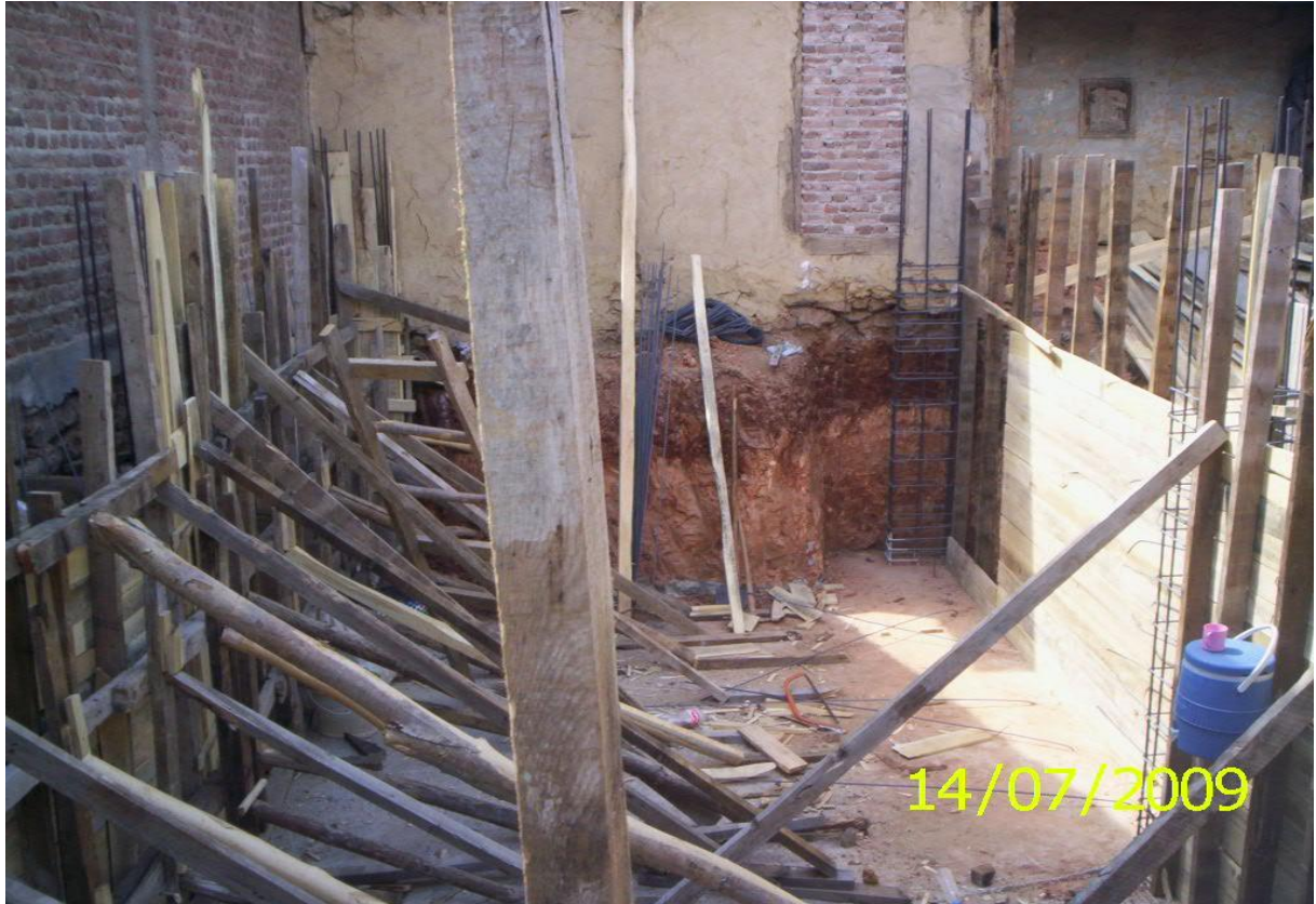
KAÇAK İNŞAATTAN GÖRÜNTÜ
